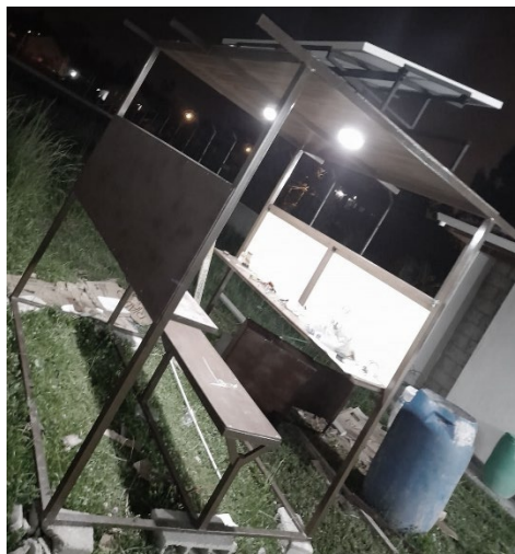
Figura 20. Estación de carga.
